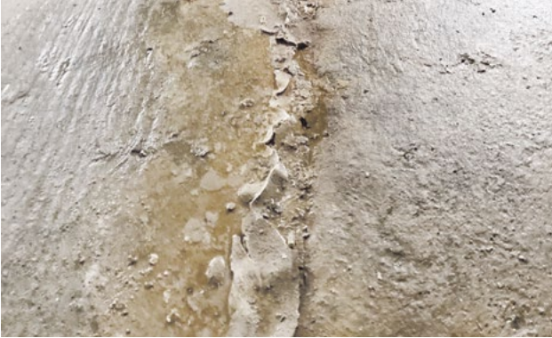
Abb. 1: Ist-Zustand der Fuge vor der Abdichtung
