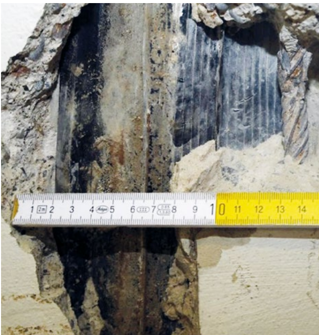
Vermessen einer brüchigen Dehnungsfuge
