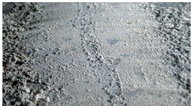
Abb. 6: Riss nach dem Verguss
