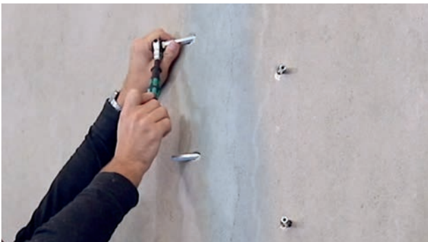
Fig. 3: Montaje de packer
