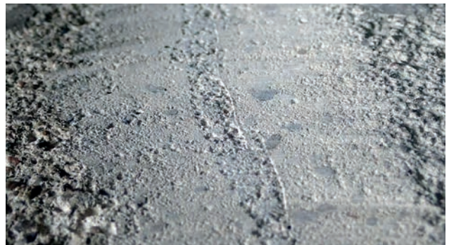
Fig. 6: Grieta posterior al encapsulado
