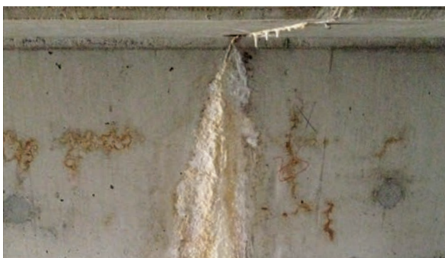
Eflorescencias de cal
