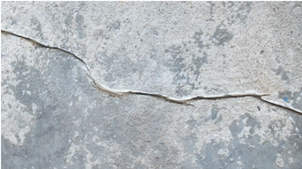
Fig. 3: Grieta preparada antes del encapsulado
