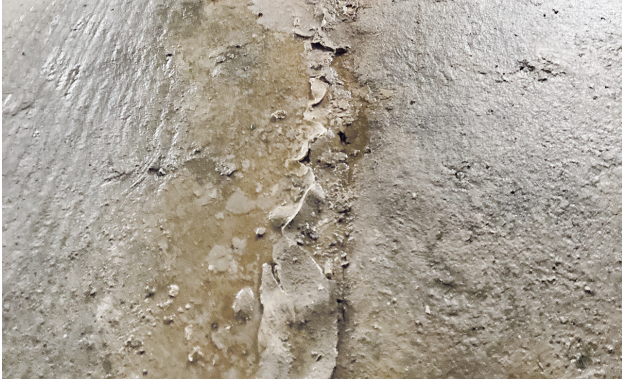
Joonis 1. Vuugi tegelik seisukord enne injekteerimist
