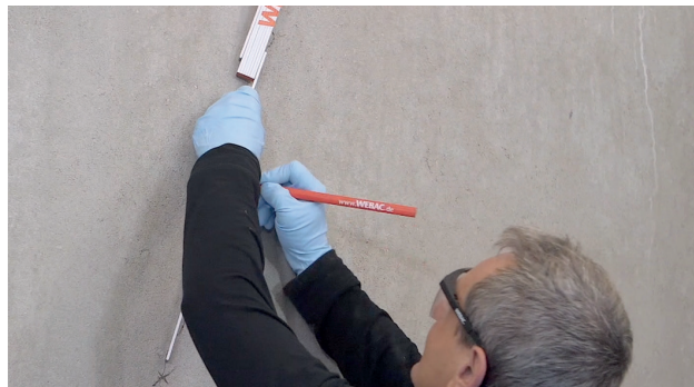
Kuva 2: Pintatulpan välin määrittäminen halkeaman yläpuolelle
