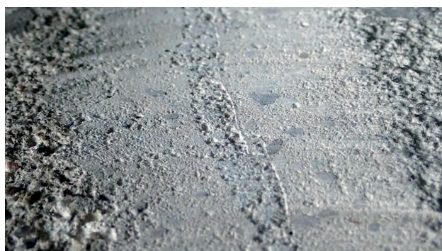
Kuva 6: Halkeama imeyttäminen jälkeen
