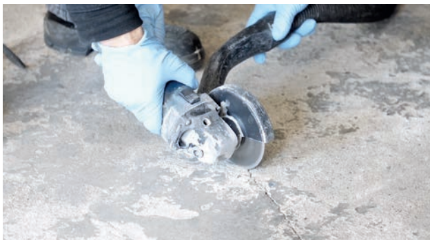
Fig. 1: Ouverture de la fissure en forme de coin
