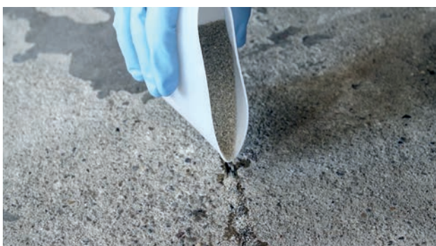
Fig. 5: Remplissage de la fissure après le scellement avec du sable de quartz
