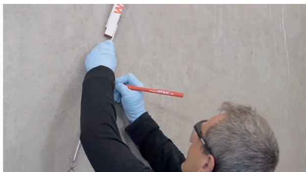
Fig. 2: Détermination de la distance entre les injecteurs à coller au-dessus de la fissure
