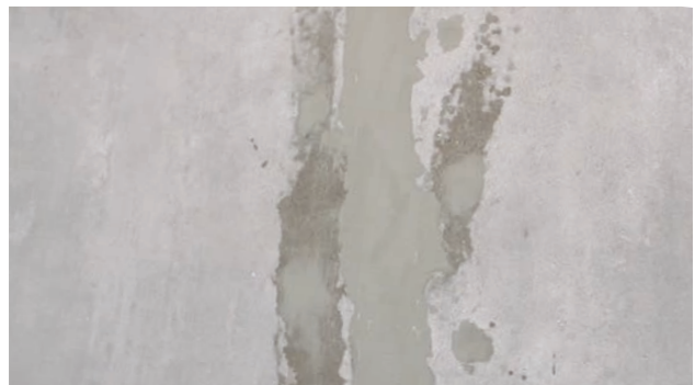
Fig. 6: Démontage des injecteurs, retrait de l'isolation et traitement ultérieur de la fissure
