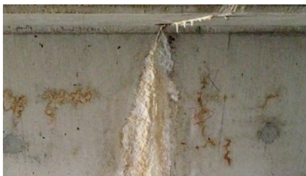
Efflorescences de chaux
