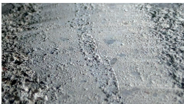
Fig. 6: Fissure après le scellement
