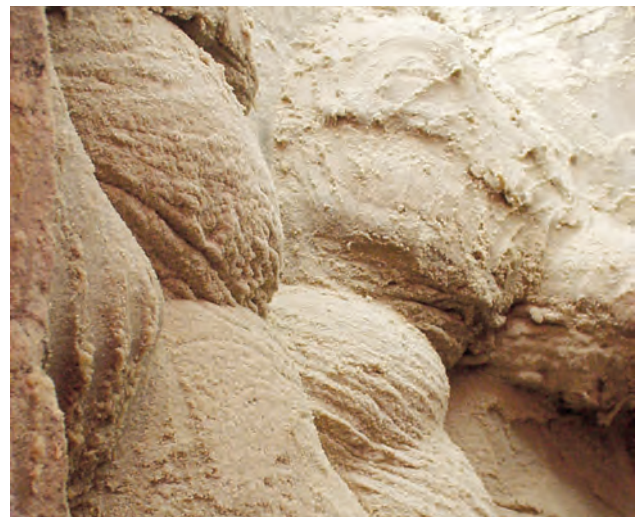
Voile de gel et de sable derrière l'élément de construction
