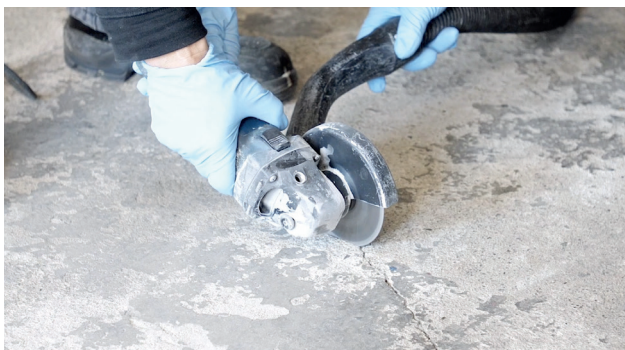
Fig. 1: Apertura cuneiforme della crepa
