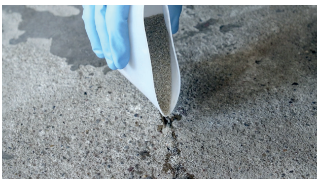
Fig. 5: Riempimento della crepa dopo la sigillatura con sabbia di quarzo
