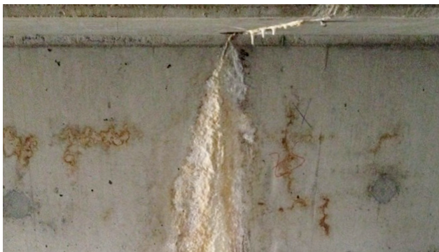
Efflorescenze di calcare
