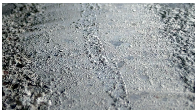
Fig. 6: Crepa dopo la sigillatura
