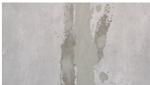
Fig. 6: Remoção dos bicos, remoção de patching e pós-tratamento da fissura
