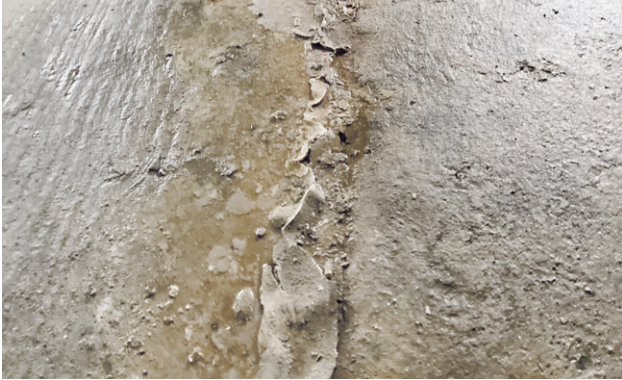
Fig. 1: Condição real da junta antes da selagem
