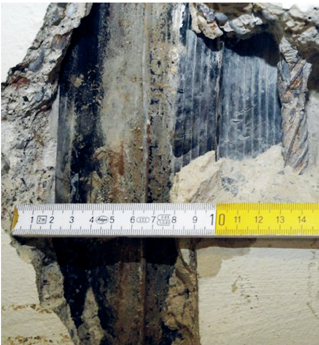
Medição de uma junta de dilatação frágil
