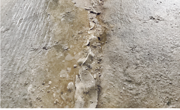
Şekil 1: Sızdırmazlık öncesi derzin gerçek durumu
